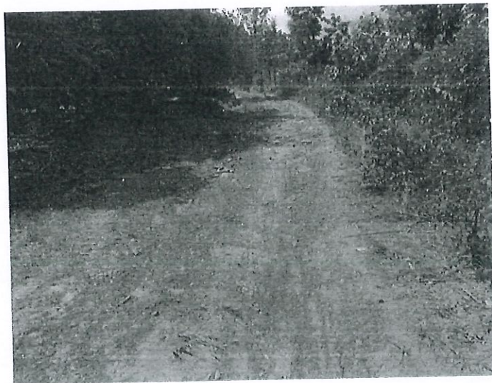
ก่อสร้างถนน คสล.สายหนองบัวเบา หมู่ที่ ๗ บ้านชำปุ่น ตำบลบ้านฝาย อำเภอน้ำปาด จังหวัดอุตรดิตถ์
